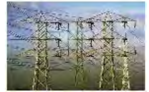
IMPIANTO ELETTRICO ESTERNO
